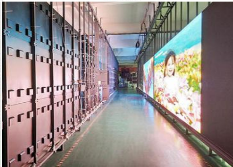
整屏老化车间
